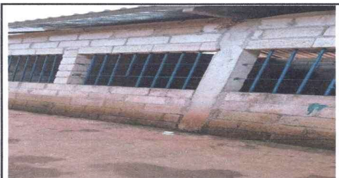
Foto 6: Se observa la necesidad de remozar los balcones.
